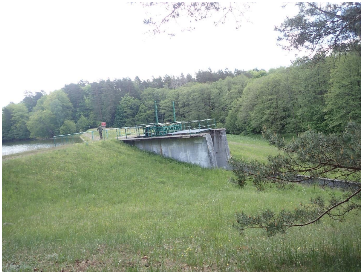
Fot. 16. Tama piętrząca wodę Słupi i Bytowej w celu jej skierowania do systemu elektrowni. Fot. Andrzej Jermaczek
