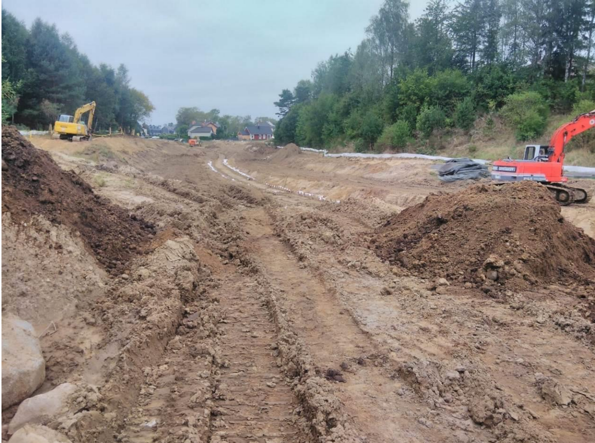
Fot. 6. Zniszczenie dna doliny cieków Potoku Wiczlińskiego w ramach projektu pn. „Odtworzenie Potoku Wiczlińskiego” wraz z budową zbiorników retencyjnych w Gdyni (lato 2020). Fot. Piotr Zięćik
