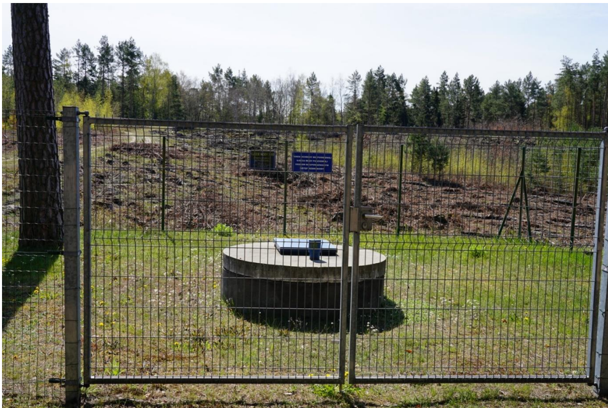
Fot. 20 Ujęcie wody S-10 w krynicy Morskiej (fot. J. Suchożebrski, maj 2021)
