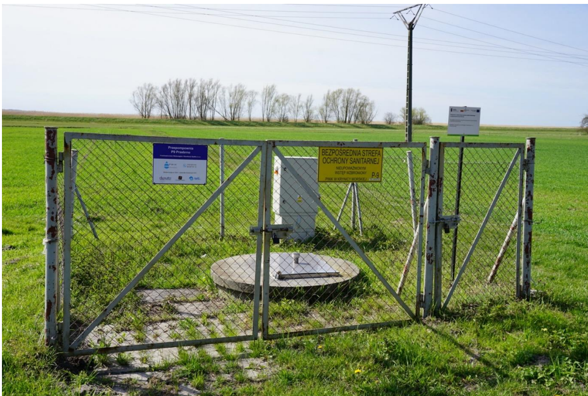
Fot. 21 Przepompownia ścieków w Przebrnie (fot. J. Suchożebrski, maj 2021)
