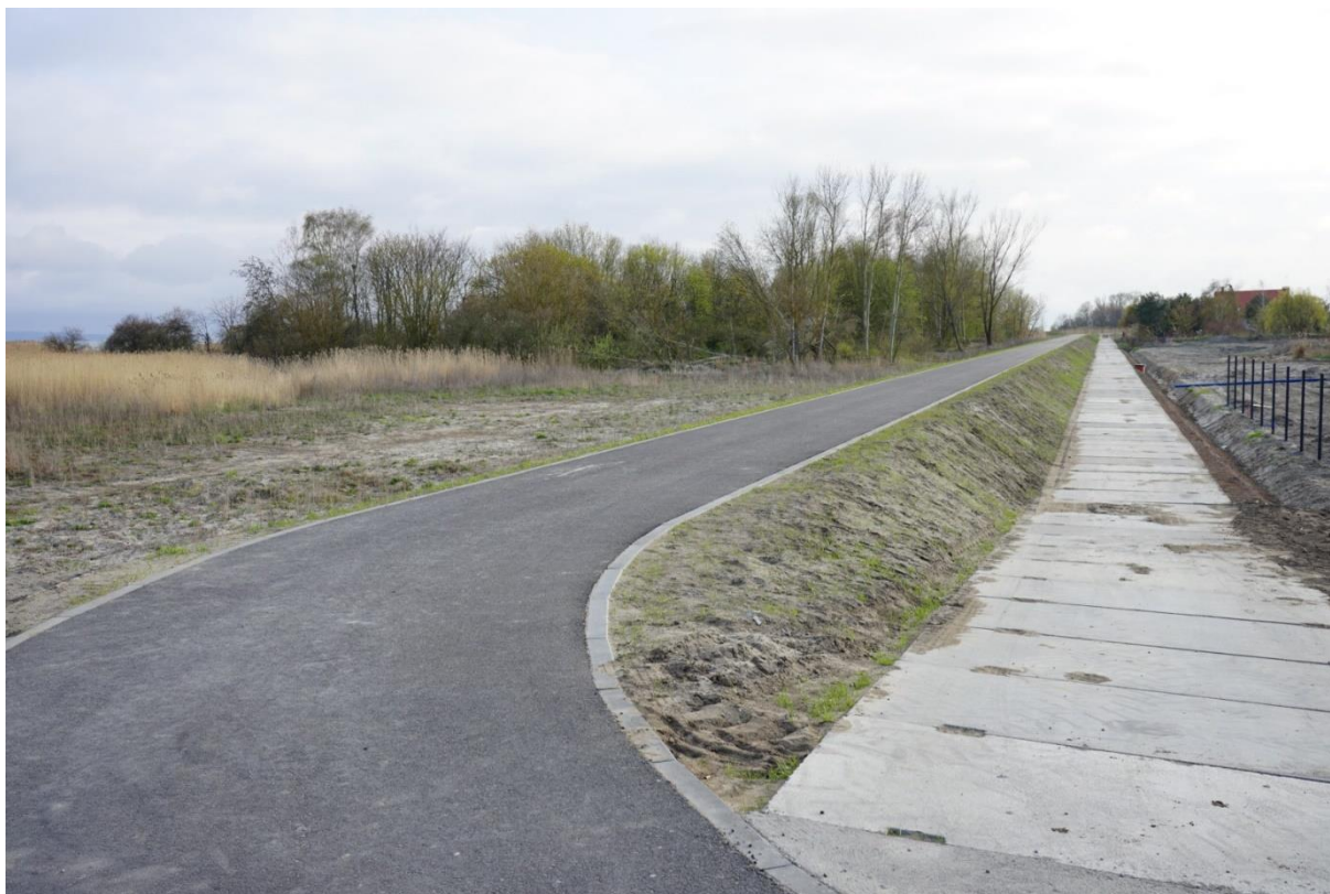
Fot. 24 Wały przeciwpowodziowe w Krynicy Morskiej od strony Zalewu Wiślanego – ochrona przed sztormami i podnoszeniem się poziomu wody (fot. J. Suchożebrski, maj 2021)
