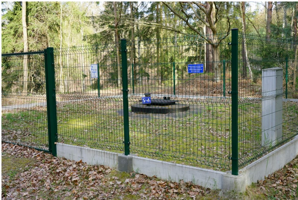
Fot. 18 Ujęcie wody S-4 w Krynicy Morskiej (fot. J. Suchożebrski, maj 2021)
