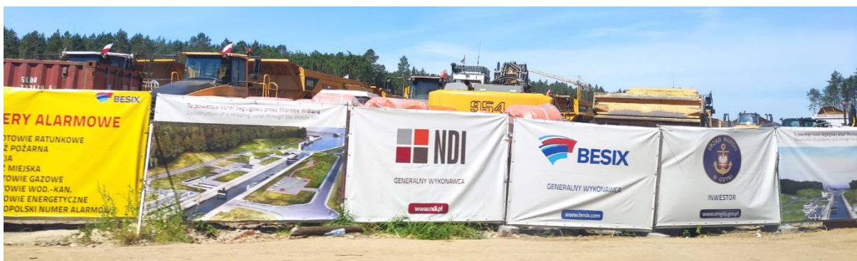
Il. 112: Przekop Mierzei Wiślanej, ogrodzenie placu budowy i ciężki sprzęt, lipiec 2020 r.
