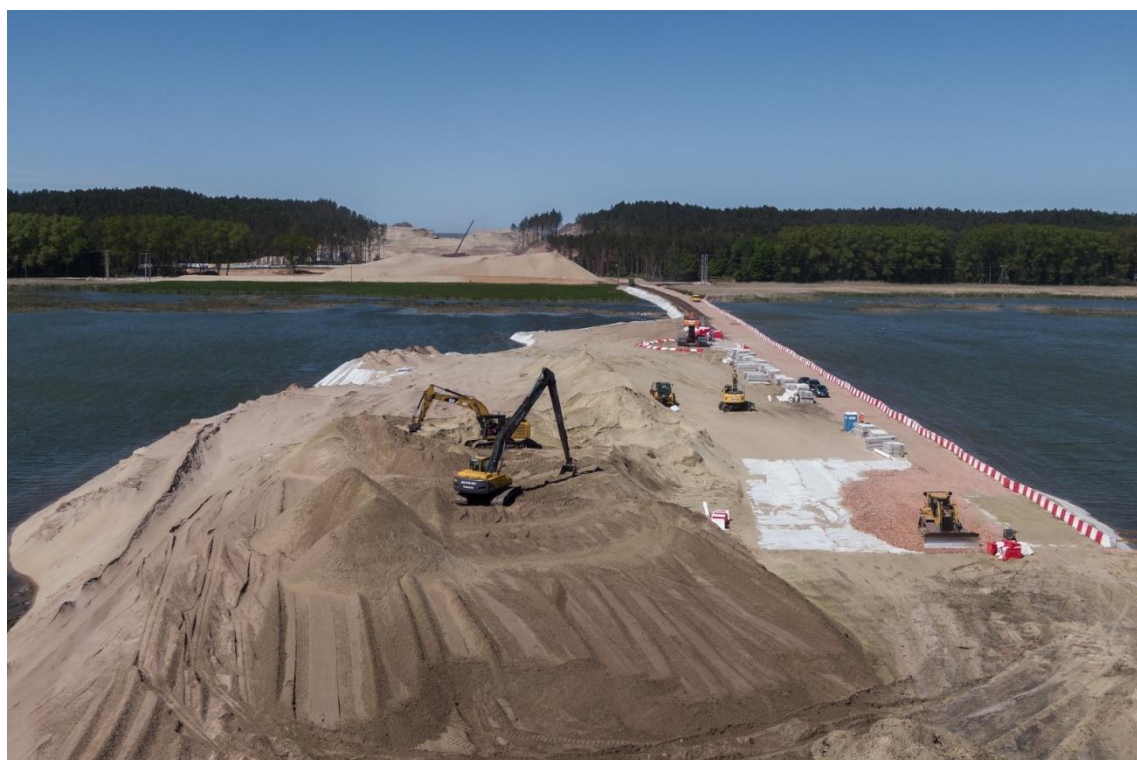
Fot. 49 Teren budowy kanału – widok od strony strefy przybrzeżnej Zalewu Wiślanego – 2020 r. (źródło: https://inzynieria.com/fotografie ).
